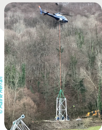
En finir avec les zones blanches Héliportage d'un pylône le 1 er mars à Herran.
