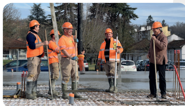
Maison Médicale de Salies-du-Salat En février les fondations ont été coulées. Raymond Nomdedeu, Vice-président délégué aux Travaux, est venu rendre visite aux ouvriers qui travaillent sur le site.
